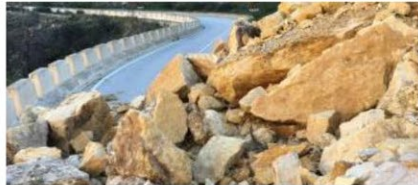
Millares urge a la diputación a actuar en la CV-580 para evitar más desprendimientos
